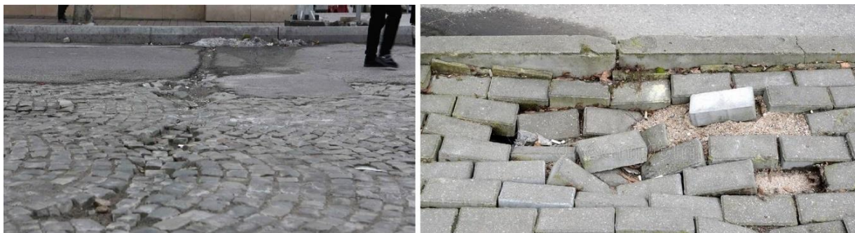
Şəkil 1. Deformasiya olunmuş səkilər.
